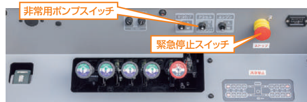
車両後端操作部
